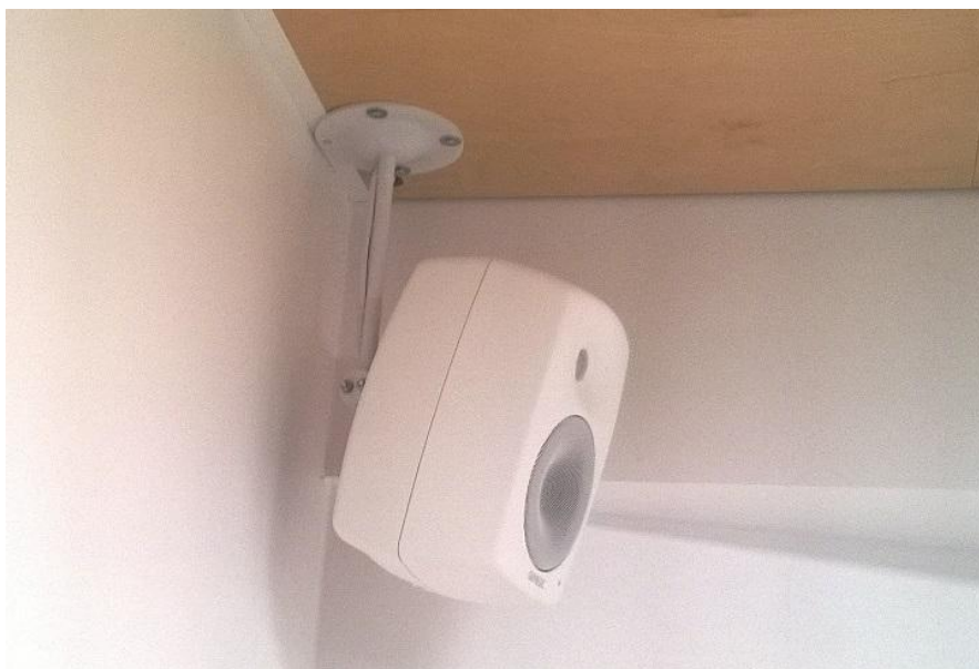
Kuva 11 – Ohjelmaaänikaiutin asennettuna säädettävään kattotelineeseen
